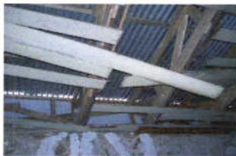
Fotografía N° 02. Cielo de la Vivienda de la Sra. María Araya Quispe.
