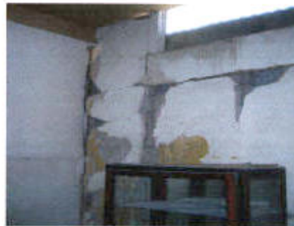
Fotografía N° 01. Fisuras y grietas en la Vivienda de la Sra. Olga Vargas Palape.
